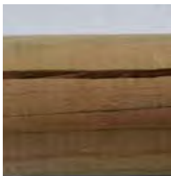
Cracks/Grietas/Fente/Risse/ Crepe/ Barsten/Fendas
