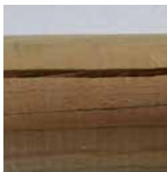
Cracks/Grietas/Fente/Risse/ Crepe/ Barsten/Fendas
